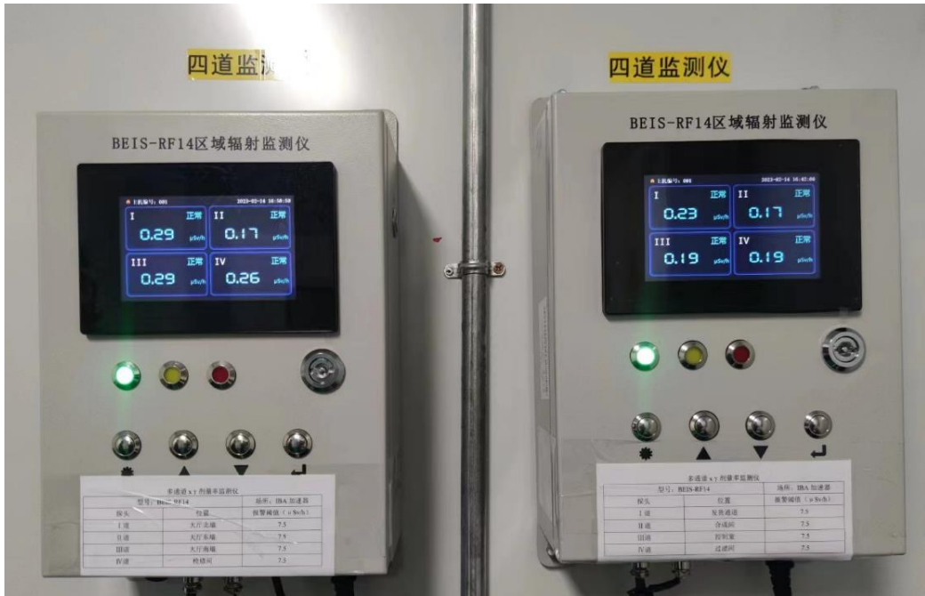
图 4-24 剂量率探头剂量率显示屏现场照片
