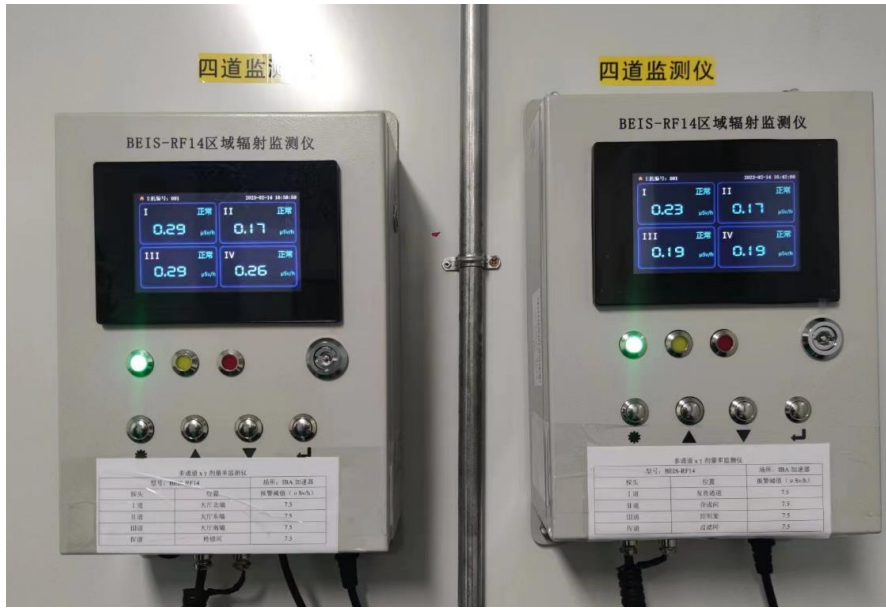
图 4-18 剂量率探头剂量率显示屏现场照片
