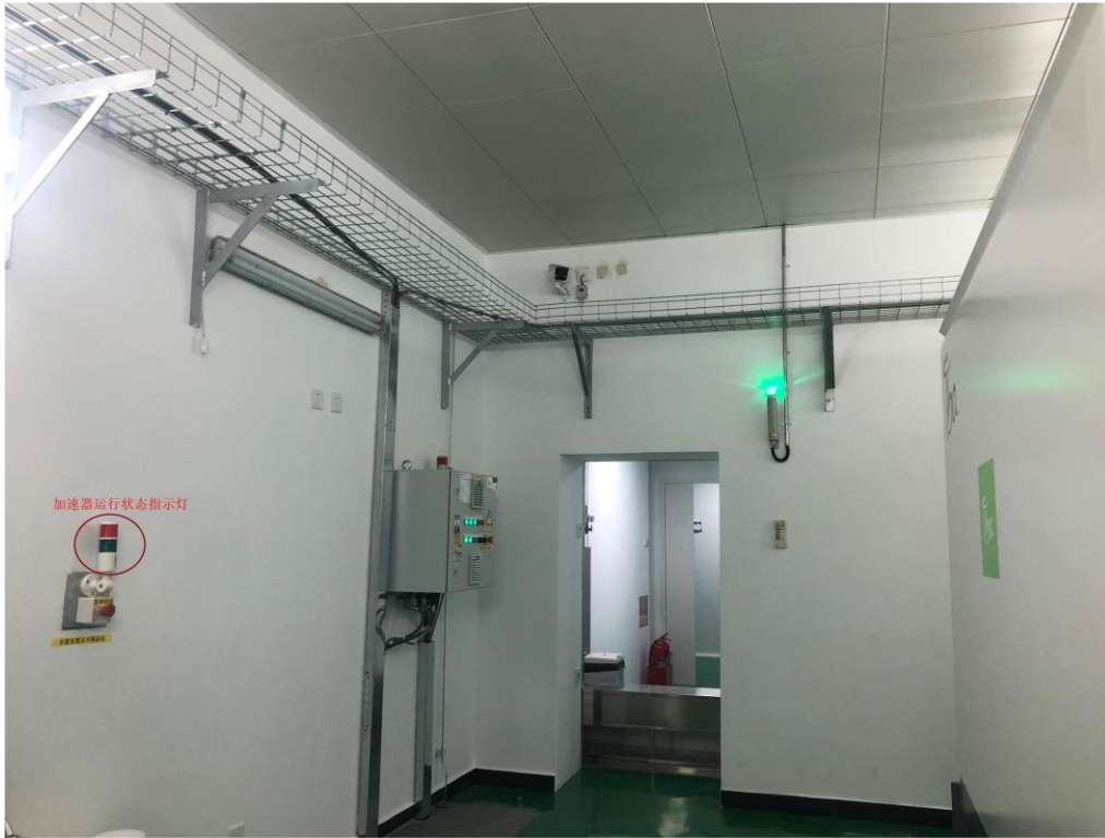
图 4-14 加速器大厅内加速器联锁指示灯设置现场照片
