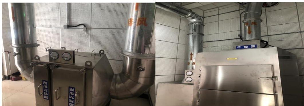
加速器大厅过滤装置
