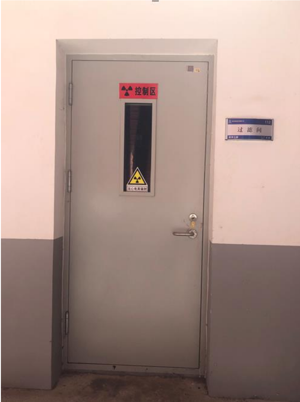
图 4-2 控制区标识现场照片
