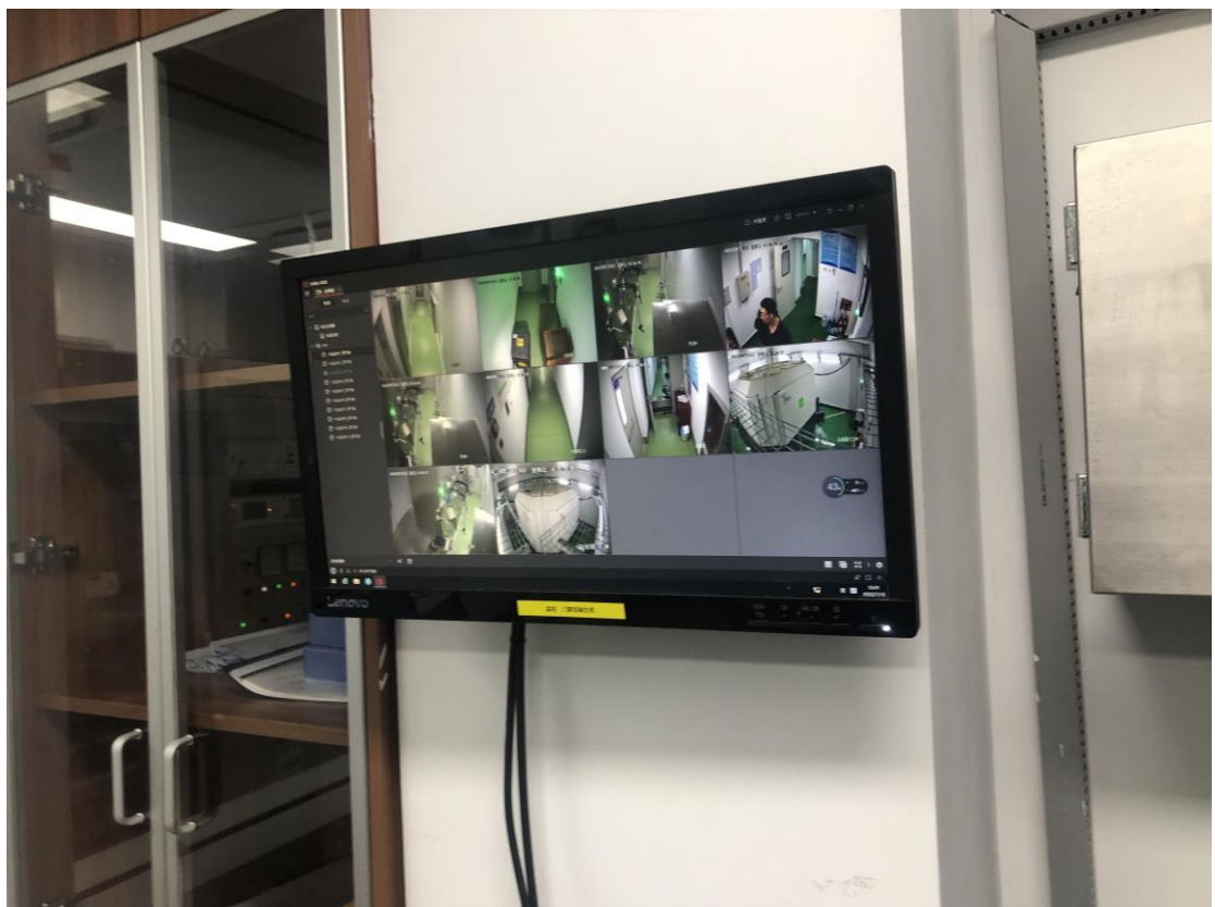
图 4-20 视频监控系统现场照片
