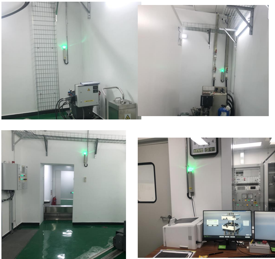
图 4-17 加速器大厅及控制室剂量率探头现场照片
