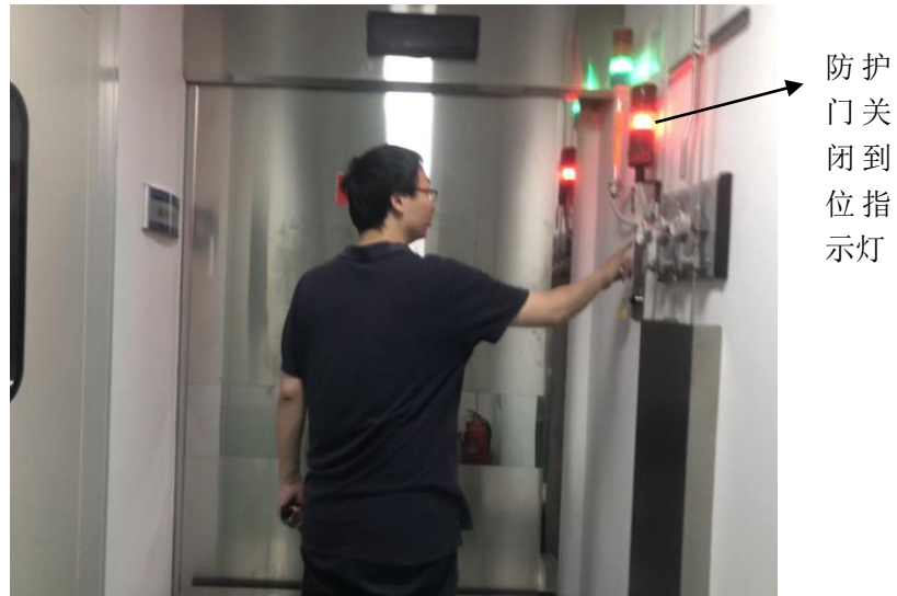
图 4-12 加速器防护门关闭时门口现场照片
