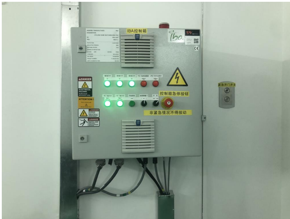
图 4-16 加速器大厅紧急开门开关位置现场照片
